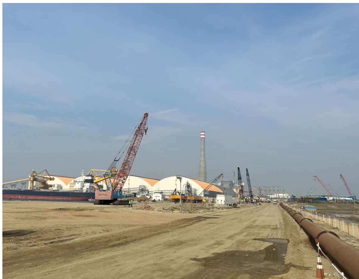
写真：JICA支援で建設中のマタバリ超々臨界圧石炭火力発電所（フェーズ1）（2023年5月にJACSES撮影）
